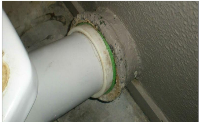
voorbeeld oude asbestaansluiting in het toilet
