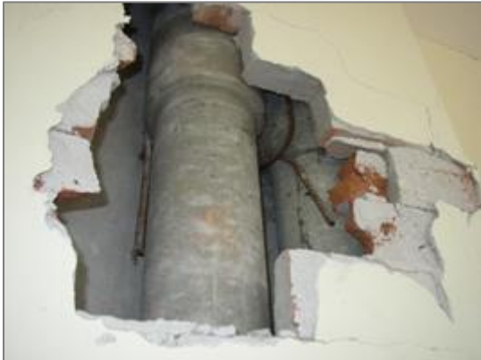
voorbeeld van een asbest standleiding
